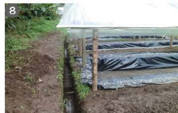
Canales de descarga
