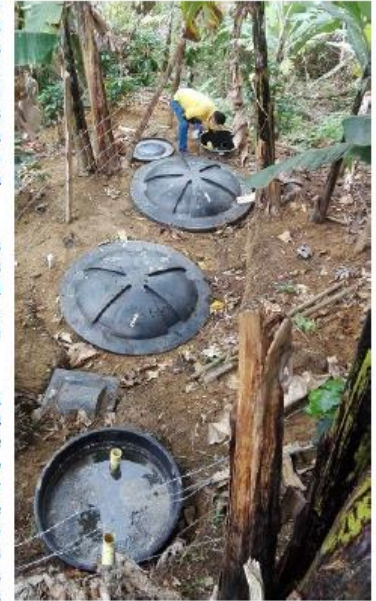
Figura 1. Sistema séptico instalado en una finca cafetera.
