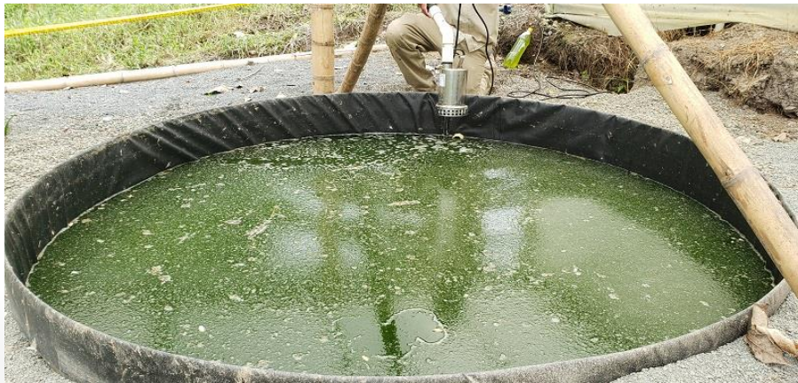
10. Recirculación de los drenados
