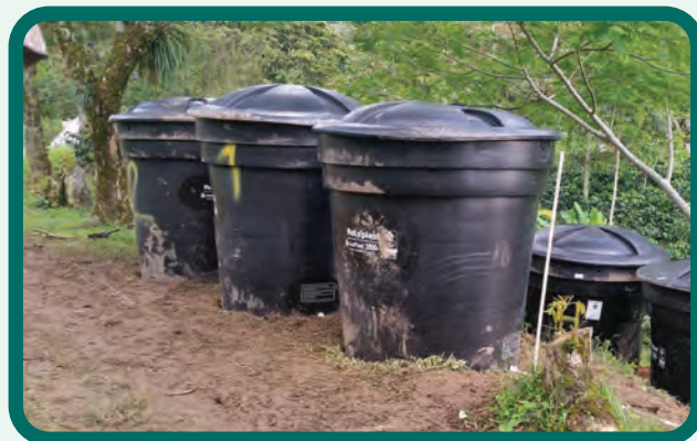
Figura 23. Tanques de almacenamiento y distribución del agua residual generada.
