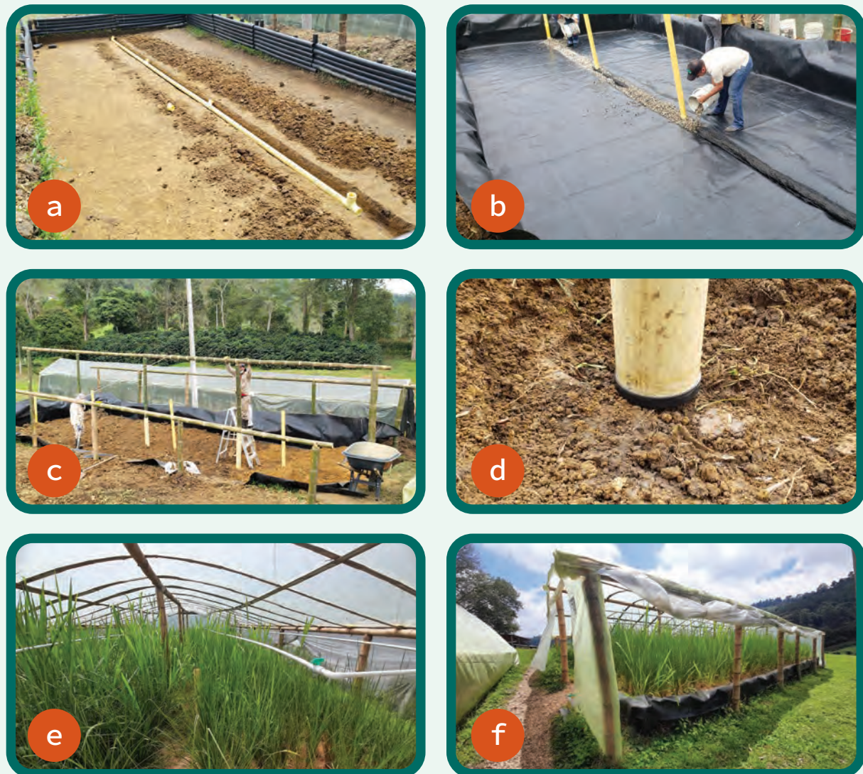
Figura 119. Instalación del filtro verde (ZLD) en la Estación San Antonio. a. Delimitación del terreno con material plástico reciclados; b. Impermeabilización del suelo con geomembrana de 20 mils e incorporación de tubos de aireación a la tubería de drenaje (1 tubo cada 3 m); c. Instalación de la estructura para soportar la cubierta plástica; d. Detalle de las columnas que soportan el techo y que descansan sobre el fondo de la excavación; e. Aspecto del material vegetal ya desarrollado y del sistema de aplicación del agua residual tratada; f. Aspecto general del filtro verde en funcionamiento.
