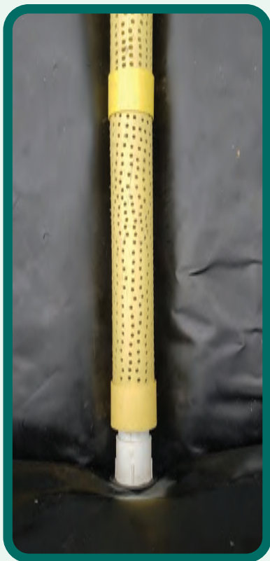
Figura 77. Aspecto de la tubería de aireación y conducción de drenados.
