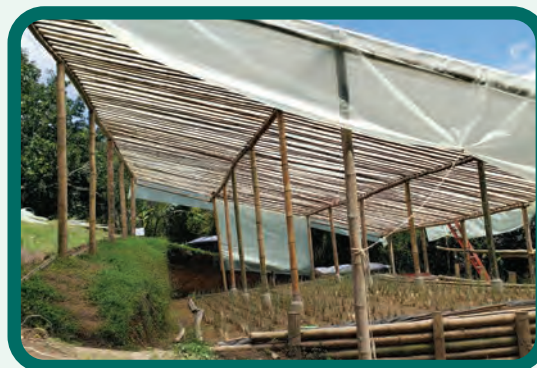
Figura 89. Techado y cerramiento del área de siembra del filtro verde utilizando plástico agrolene.
