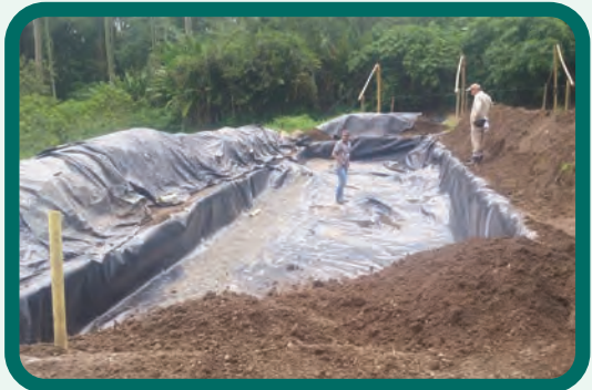
Figura 104. Impermeabilización de la excavación con geomembrana de 20 mils y llenado con suelo.
