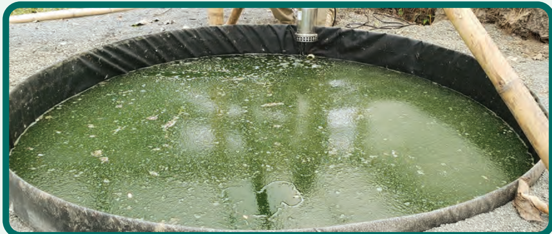
Figura 110. Utilización de una bomba sumergible para llevar nuevamente los drenados a la unidad de aplicación de los filtros verdes.
