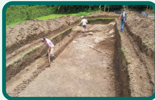
Figura 103. Excavación de 5 m x 20 m x 0,70 m para la construcción de cada uno de los filtros verdes.
