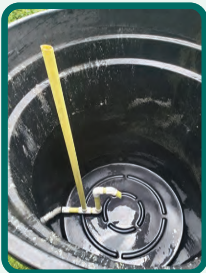
Figura 35. Dispositivo de toma del agua residual en los tanques de almacenamiento.
