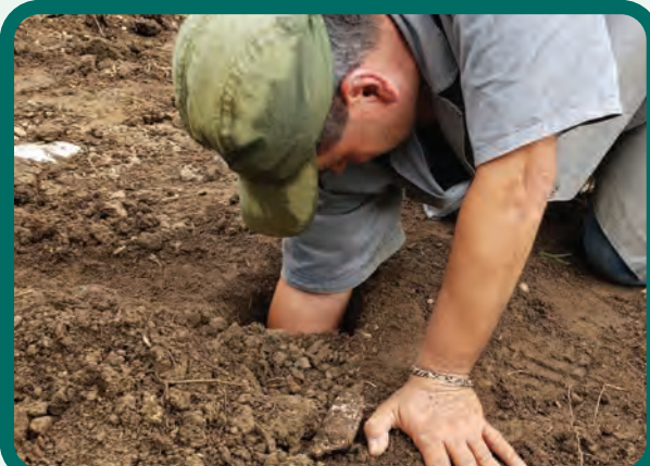
Figura 31. Elaboración de una perforación en el centro de los filtros verdes para la instalación de los sensores.
