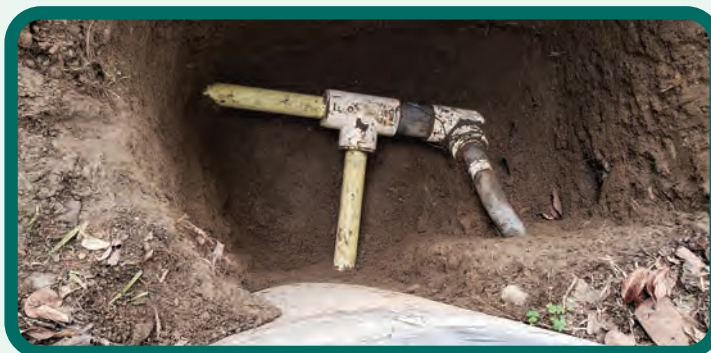
Figura 101. Válvula desaireadora a la entrada de los reactores hidrolíticos del SMTA.
