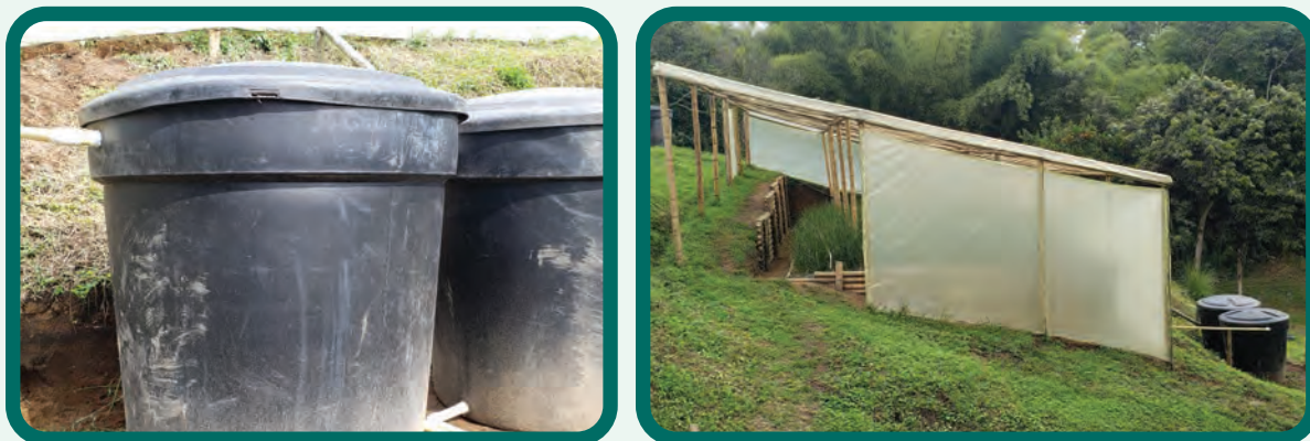
Figura 96. Aspecto y localización de la unidad de drenados.
