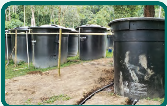
Figura 102. Canalización de los efluentes del SMTA hacia la unidad de aplicación de los filtros verdes.
