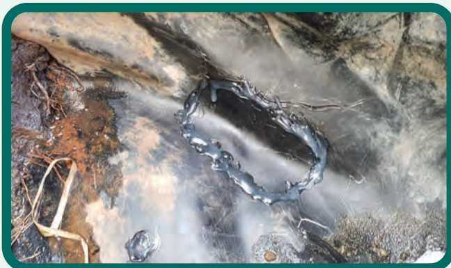
Figura 130. Aspecto de la silicona aplicada sobre el daño presente en la geomembrana.
