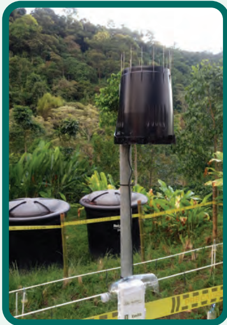
Figura 20. Instalación del datalogger y conexión a los sensores de humedad y al pluviómetro.
