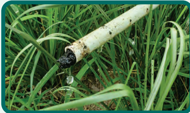
Figura 123. Aspecto del lodo, depositado con el tiempo, en la tubería de riego.
