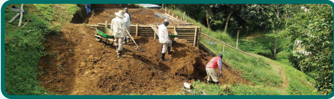
Figura 81. Llenado de la excavación del filtro verde manteniendo el perfil original del suelo.
