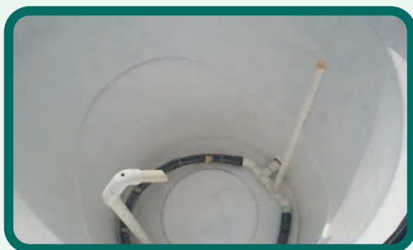
Figura 70. Aspecto del dispositivo interno para el tratamiento primario de las aguas residuales del café.
