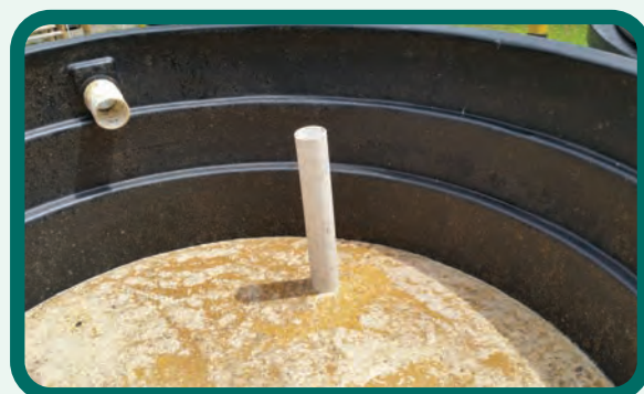
Figura 71. Aspecto del agua residual en el tanque de tratamiento primario.
