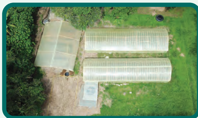
Figura 108. Vista aérea de los filtros verdes instalados en Cenicafé sede La Granja.
