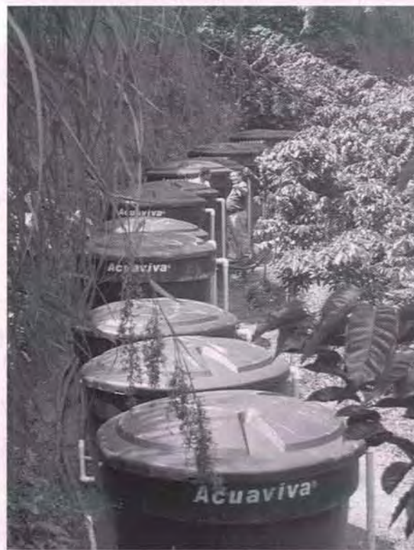
■ Figura 42. Sistema integral de tratamiento de lixiviados en la Hacienda Veracruz.
