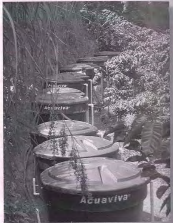
■ Figura 42. Sistema integral de tratamiento de lixiviados en la Hacienda Veracruz.
