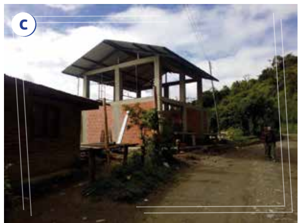
Figura 37 a. Vista de la fachada principal del beneficiadero ecológico comunitario de Inzá. b. Vista del área de recibo del café. c. Vista de la zona de ingreso a área de maquinaria.
