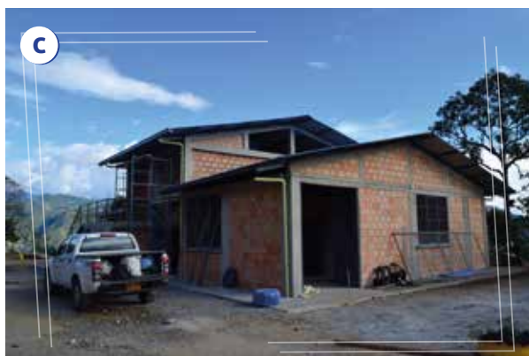
Figura 46 a. Vista general del beneficio ecológico comunitario de Sotará. b. Vista general de la maquinaria instalada. c. Vista general de los detalles del manejo ambiental.
