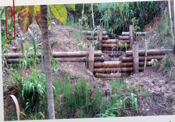
Trincho con vertederos en guadua
