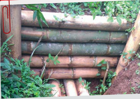
Filtro en guadua
