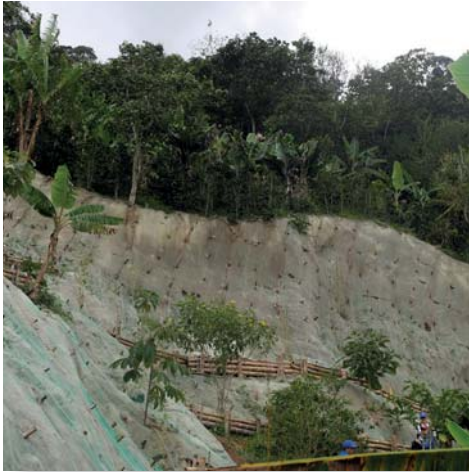
Figura 73. Protección de superficie de talud.
