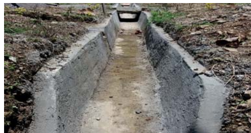
Figura 38. Drenaje superficial (batea).
