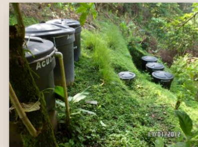
Sistemas de tratamiento ARC
