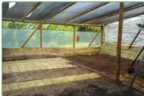
3. Instalar el falso piso en esterilla y con pendiente del 2% para recolectar lixiviados.
