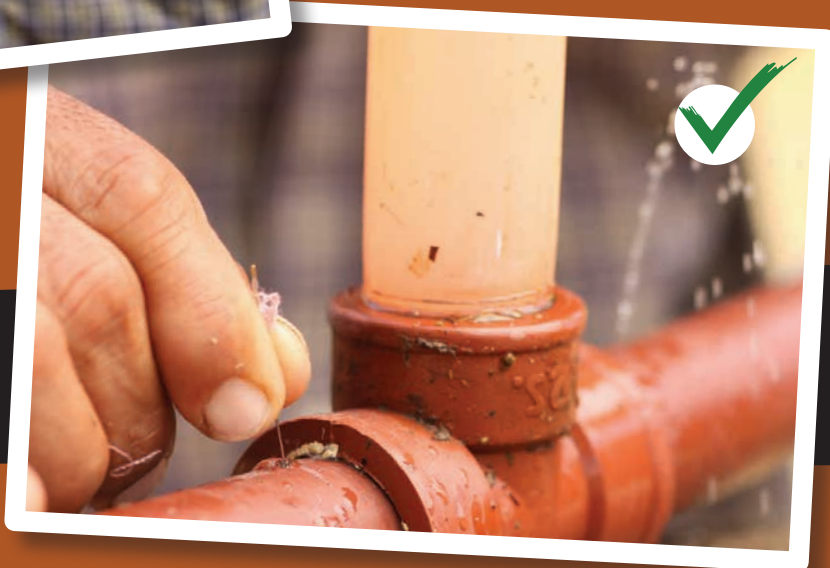
Figura 8. Revisión y mantenimiento de los orificios de salida, con una aguja de 0,5 mm de diámetro.
