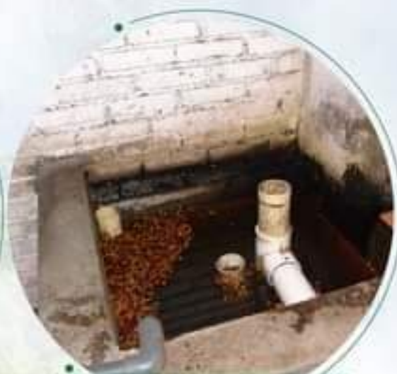
Tanque sifón con recirculación
