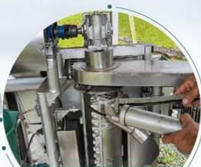
Mantenimiento de los lavadores
